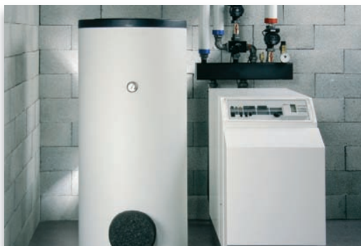
■ Contrôle de chauffage et gestion eau chaude sanitaire : Pompe à chaleur
