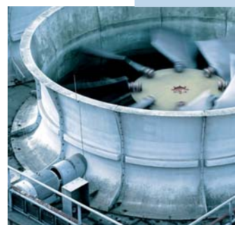
Surveillance de ventilateurs.
