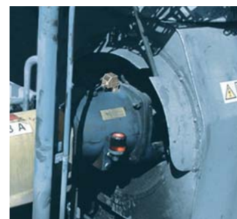
Surveillance de pompes - également en zone ATEX.
