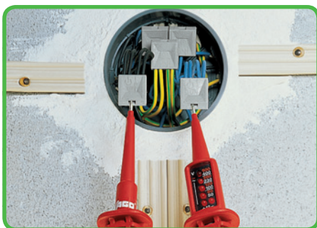
Contrôle de tension, ici, avec des bornes pour boîtes de dérivation.
