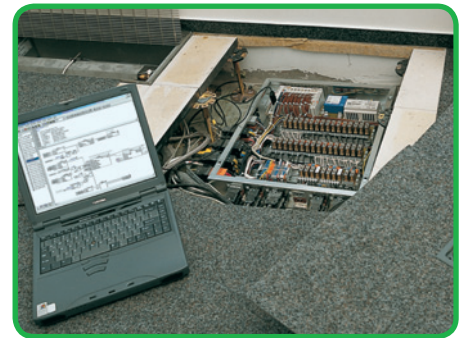
Installation électrique en faux plancher
