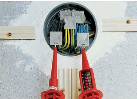
Contrôle de tension, ici, avec des bornes pour boîtes de dérivation
